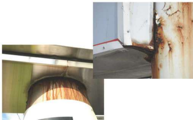
発見した劣化箇所
